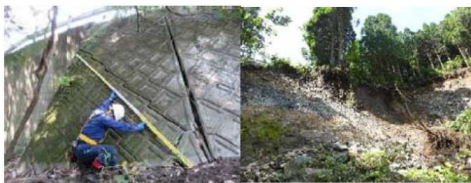
写真-6 擁壁の変状
