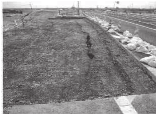
写真4-1 盛土除去後のクラック観察
