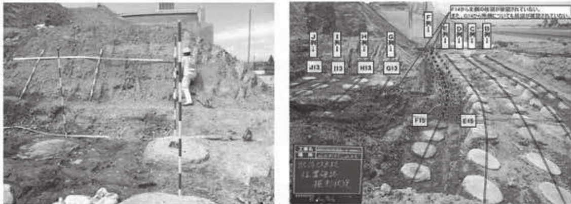
写真4-2 盛土材の落ち込みとE列、F列、G列改良柱の押し込み
